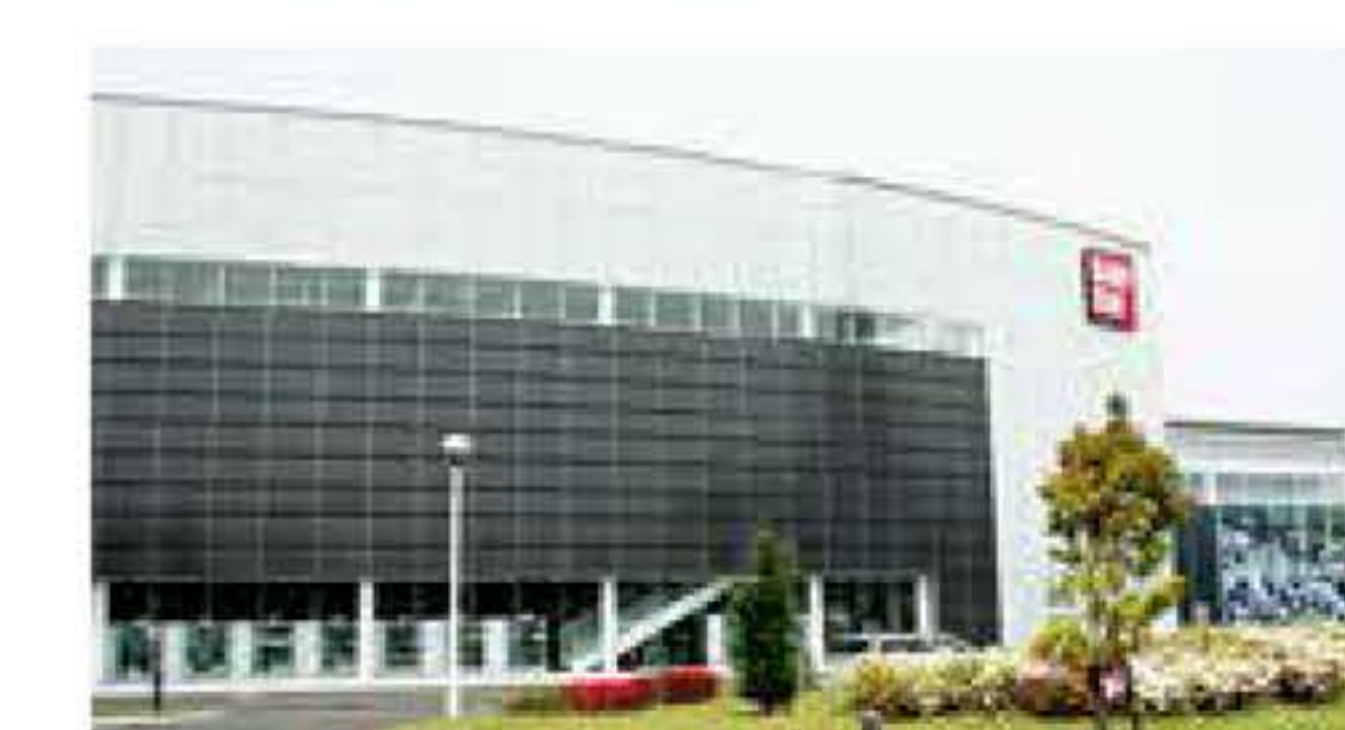
壁一面に設置された大型ソーラーパネル
